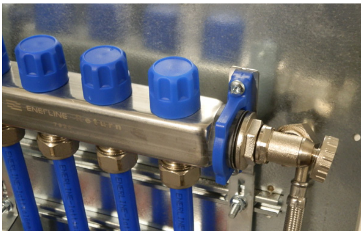
Kuva 3. Ilmauspäädyn venttiilin avaaminen.
